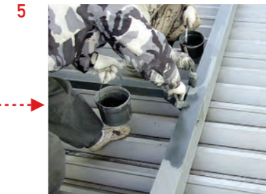
30～60分後、塗装面が乾燥している ことを確認し、2回目の塗装を行う
